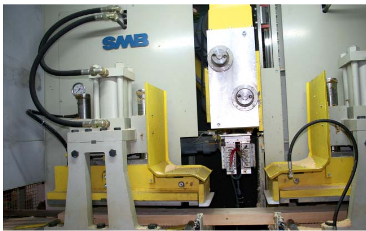
Kompakt-Keilzinkenanlage wurde wie die gesamte Linie in der Vöhringer Technischmiede konzipiert und gebaut
